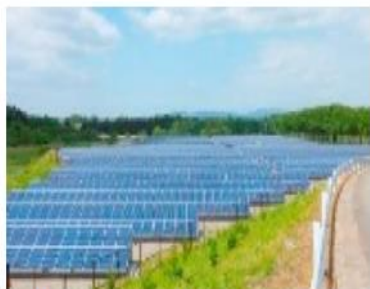
メガソーラー (太陽光発電所)
